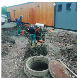
Oprava nefunkční kanalizace v areálu Klondyky, oddělení dešťových odpadních vod od splaškových
