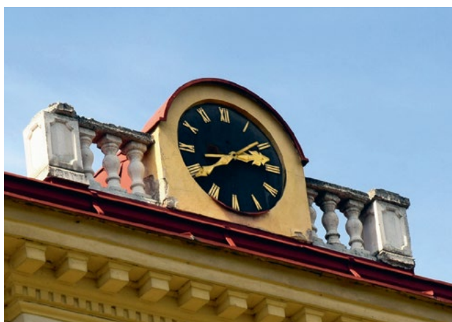
Fotografie detailu atiky s hodinami (2025) - už si říká o opravu
